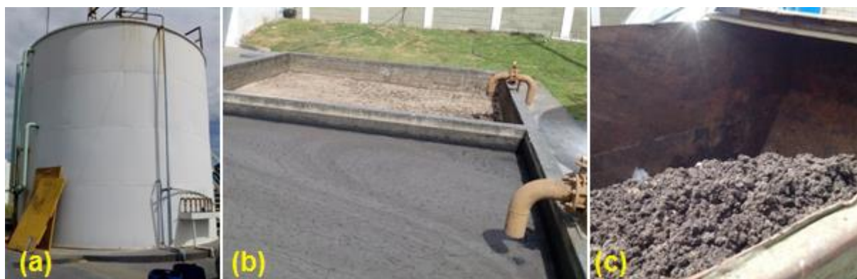
Figura 3 –Reator UASB que recebe o efluente para tratamento (a), Leitos de secagem do lodo da ETE Campos Dourados (b) e Caçamba em que o lodo é colocado após secar no leito de secagem e aguarda transporte para disposição final em aterro sanitário (c).
