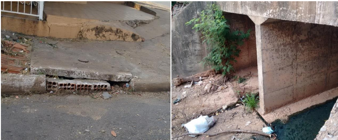
Figura 4 e 5 - Bloqueio da seção da boca de lobo e lixo nas galerias pluviais.
