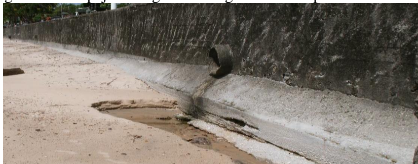
Figura 5 – Despejo de esgoto ao longo da orla da praia do Murubira.
