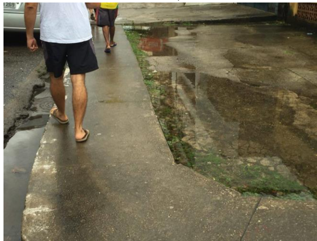
Figura 4 – Desnível na calçada impedindo escoamento das águas pluviais para a sarjeta, na Avenida 25 de Setembro, no bairro do Marco
