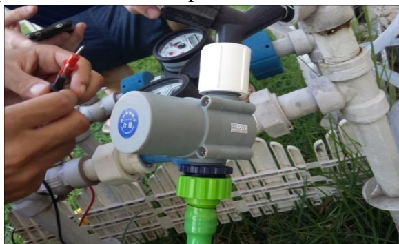
Figura 5 – Protótipo instalado em rede hidráulica residencial.
